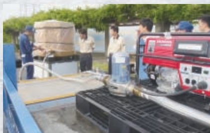
給水部災害対策訓練強化月間における 仮設給水車組立訓練 5/19 (木)
