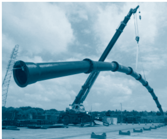
耐震継手を有する耐震管を吊り下げた状況 写真：株式会社 クボタ提供
