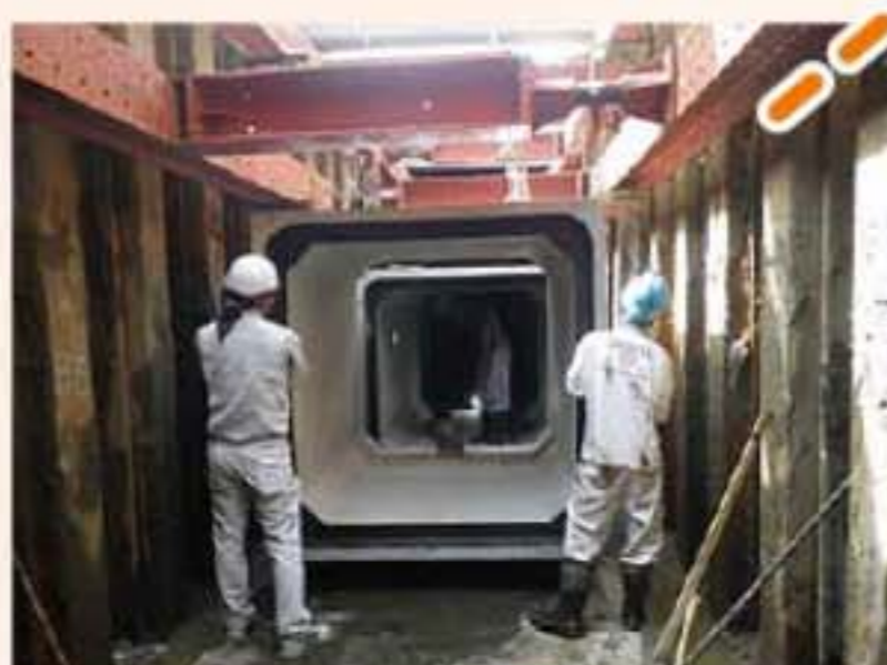
雨水貯留函(管)
