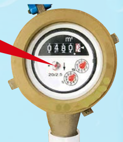
水道メーター
