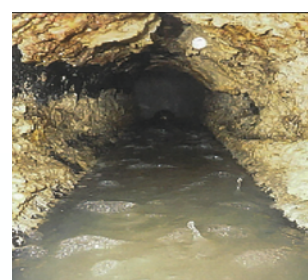
下水道管に付着した油脂類
