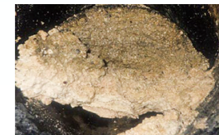
▲下水道管に付着した油脂類
