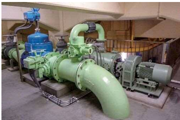
小水力発電設備(横曽根浄水場)
