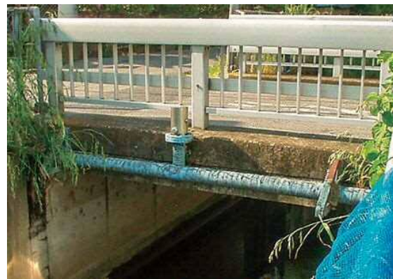
塗装の劣化した橋梁添架配水管
