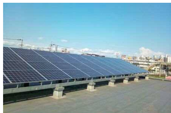
太陽光発電設備（芝園配水場）
