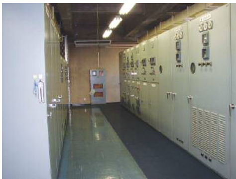
受配電設備装置（石神配水場）
