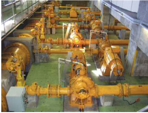
配水ポンプ（石神配水場）
