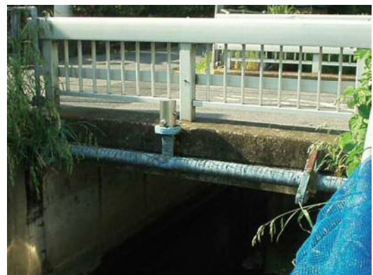
塗装の劣化した橋梁添架配水管
