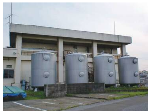
急速ろ過装置（鳩ヶ谷浄水場）
