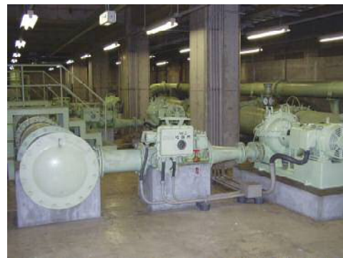
配水ポンプ（南平配水場）
