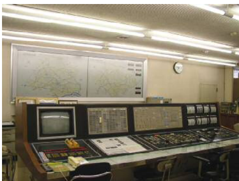
中央操作室（石神配水場）
