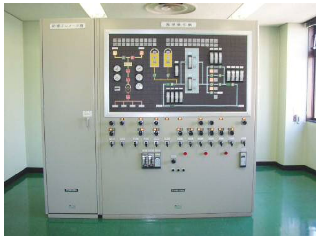
中央監視装置（南平配水場）
