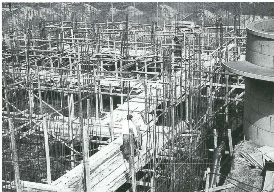
第2配水池建設工事 上青木第2浄水池工事の様子(昭和34年頃)
