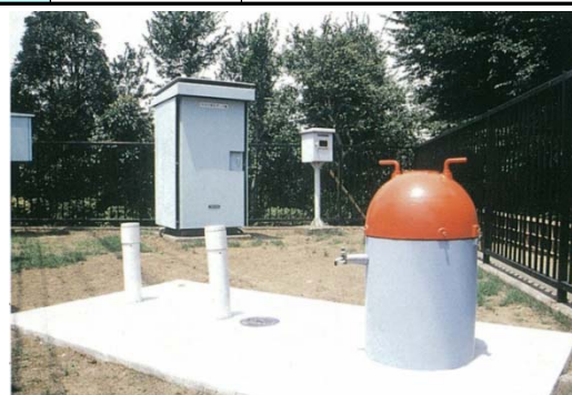
自己水源である取水井
