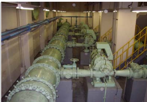
配水ポンプ設備
