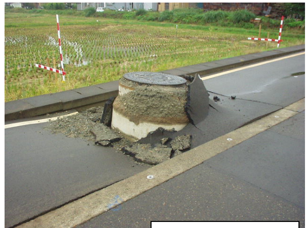
新潟中越地震被害状況
