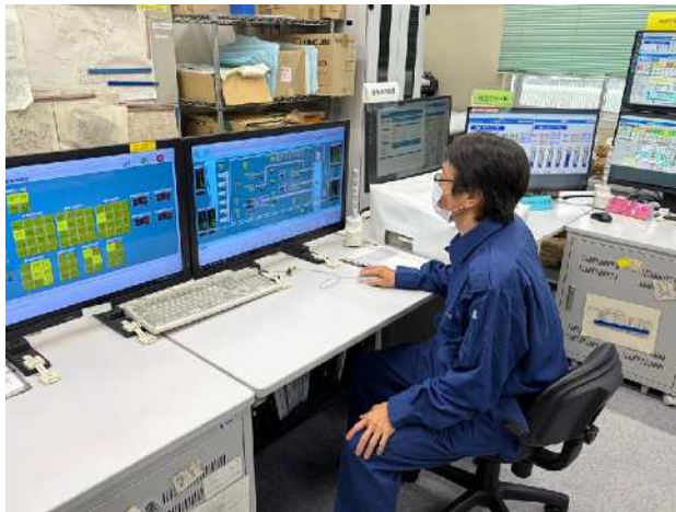
⑥元郷排水ポンプ場から無人施設への遠隔操作訓練 (ポンプ場班)
