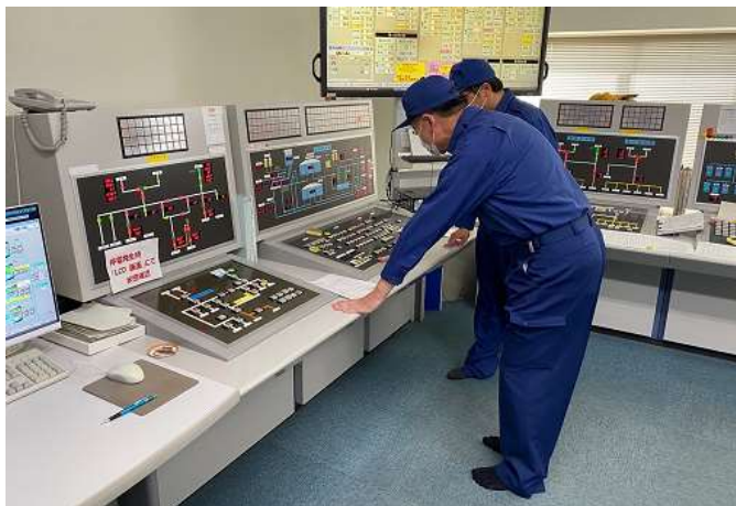
③遠隔制御設備の操作訓練（浄水施設復旧班）
